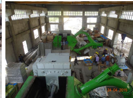
Upper Mai HEP (9.98 MW) - Ilam
