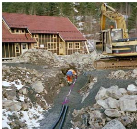
Fig 5.22 Rørgate i et nærvarmeanlegg. Kilde: www.Grip.no
