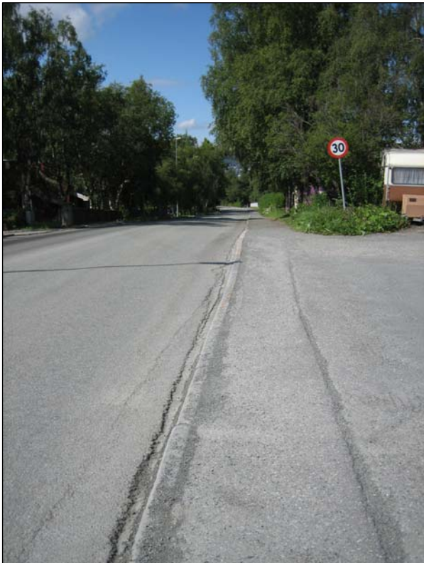
Bilde 14: Deler av Jonsvannsveien er preget av smale fortau, mange private utkjørsler og mye vegetasjon som hindrer sikten. Dette presser syklister ut i veibanen og mange føler seg uttrygge når de sykler blant biler. Det anbefales at de eksisterende sykkelveiene i Jonsvannsvei knyttes sammen slik at det blir en helhetlig sykkeltrase.
