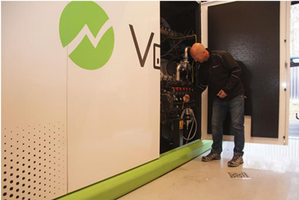
CHP-maskinen på Evenstad har vært i drift i cirka to måneder. På bildet driftsleder i Statsbygg, Per Anders Westgaard. Foto: Statsbygg
